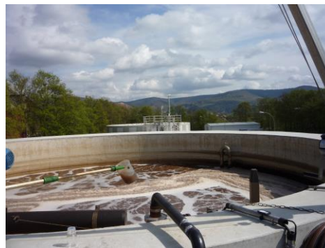
Деаммонификация на очистных сооружениях в Гейдельберге
